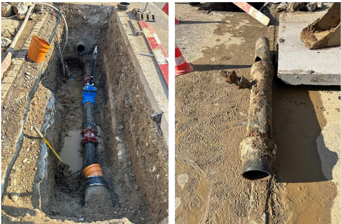
Bild: Defektes Rohr
