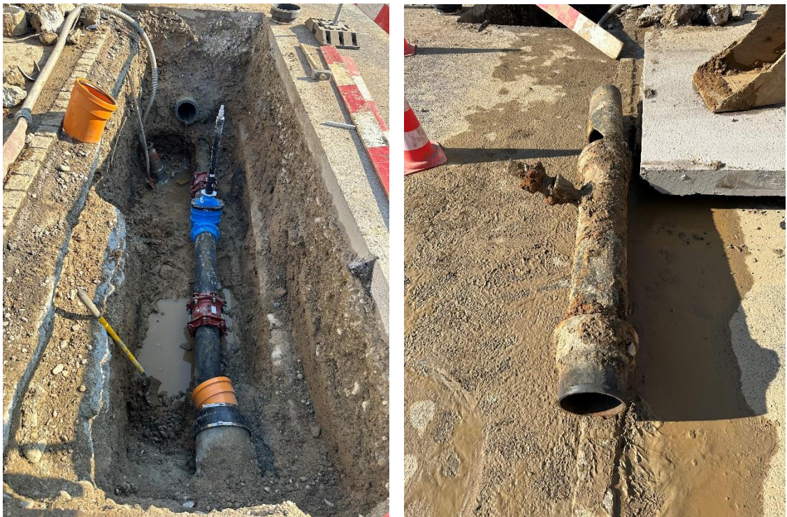
Bild: Defektes Rohr
