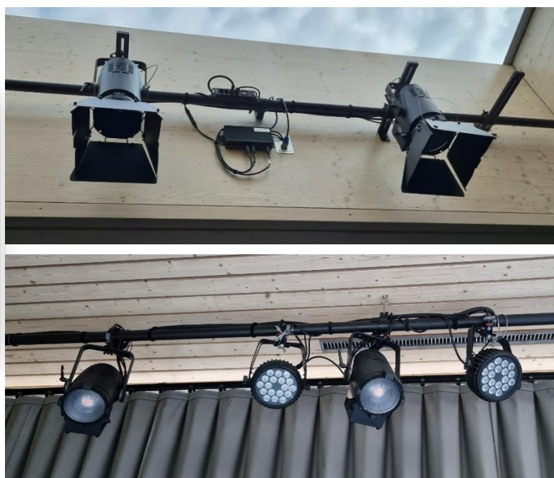
Abb. Scheinwerfer Lichtanlage Riederhalle mit separater Bedienung
